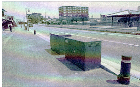
▲ 通常電線地中化で使用される地上機器 (写真1)
